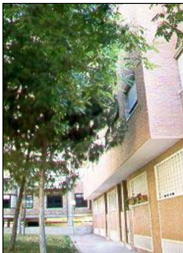
Separación inadecuada entre árboles y edificios
